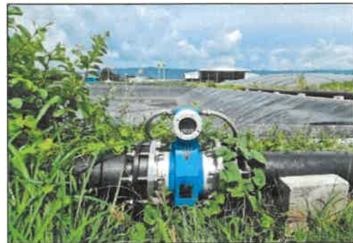
มิเตอร์วัดปริมาณก๊าซชีวภาพก่อนเข้าสู่ระบบ H 2 S-Bio Scrubber
