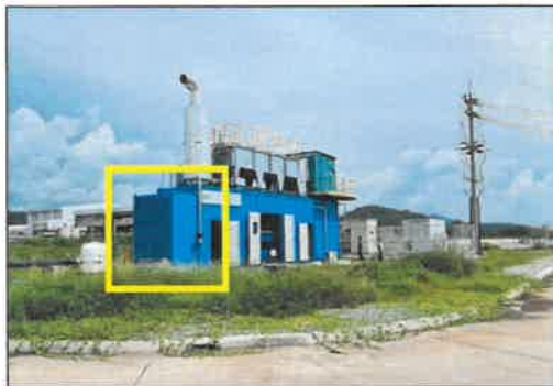
ระบบระบายอากาศของอาคารผลิตไฟฟ้า ของโครงการ
