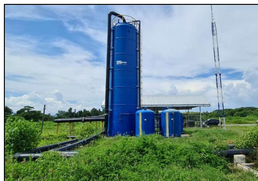
รูปที่ 1-6 ระบบปรับปรุงคุณภาพก๊าซชีวภาพ ( H_2S Bio-Scrubber)
