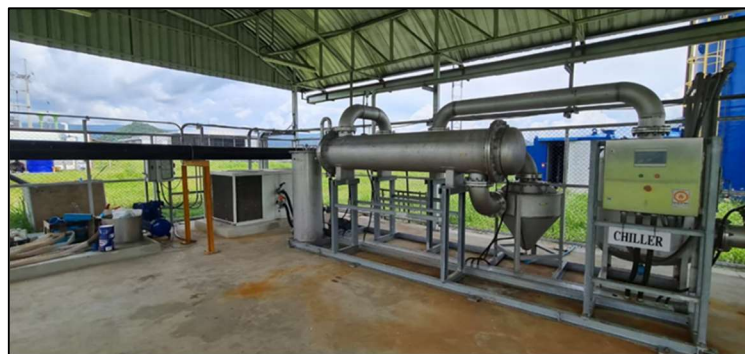
รูปที่ 1-7 ระบบกำจัดความชื้น (Gas Chiller)
